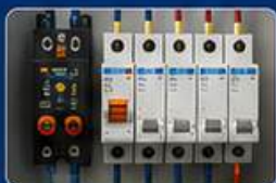
THIẾT BỊ ĐIỆN
